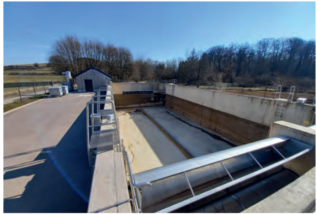
Becken mit Pumpstation.
