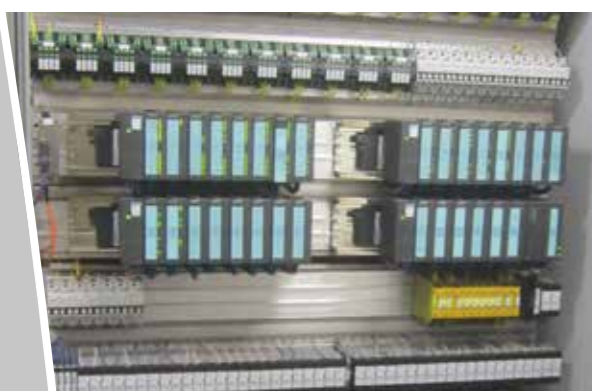
Die Schaltanlagen entstehen bei AGRANA in eigener Werkstatt
