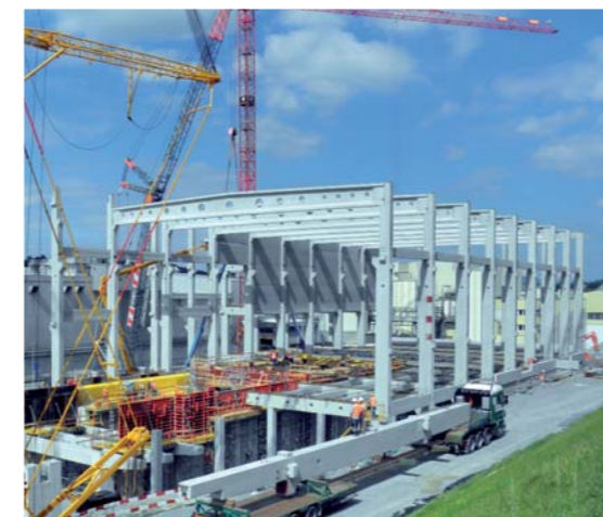
Über eine Webcam konnte man jederzeit den aktuellen Baufortschritt bei der Papierfabrik in Perlen (Schweiz) sehen.
